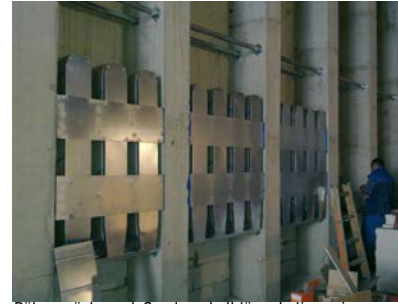
Bühnenrückwand, Sonderschalldämmkulissen im gemauerten Schacht
