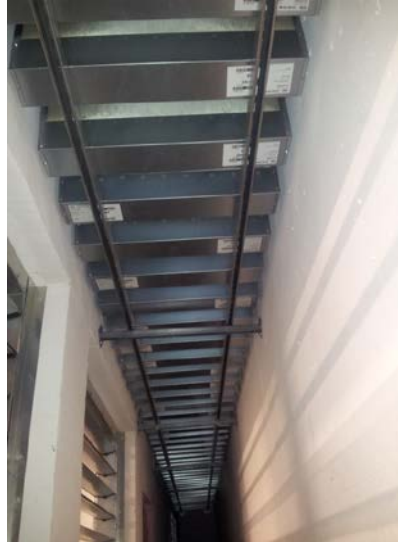
Frischlufteinströmung über Bodengitter
